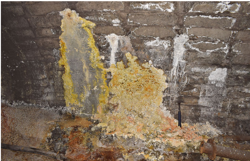
Obr. 3 Akumulácia sekundárnych síranov tvorená alunogénom, pickeringitom, melanteritom, sadrovcou a natrosideritom na stene chodby 08301-0 pri meračskom bode 1610 na II. horizonte Východnej šachty v Bani Handlová (odberné miesto č. 2). Foto P. Myšľan.
