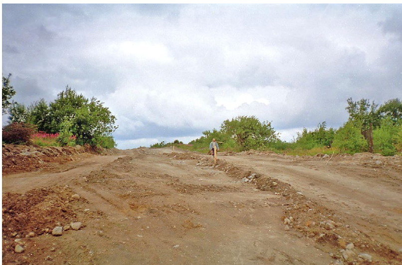
Obr. 2 Výstavba nové silnice na Cínovci, která přešla haldy po historickém dolování. Foto Z. Dvořák, 1999.
